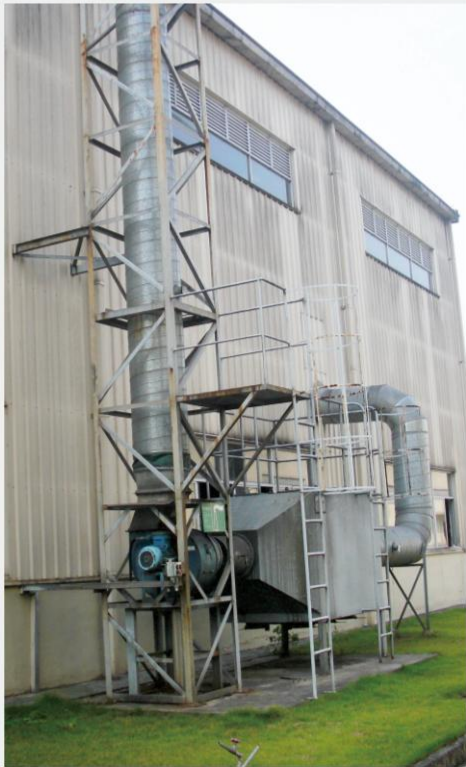
废气处理系统
